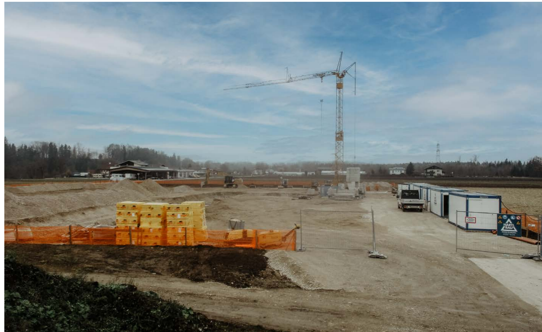
SCHIESSL KÄLTETECHNIK, VORCHDORF 2021-2022
